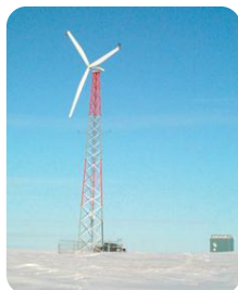
Автономная ветроэнергетическая станция
